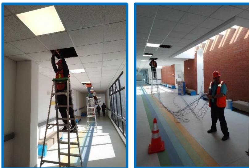
Proyecto de cableado estructurada IP, PBX y Zona WiFi en el Hospital Nuevo Chimaltenango
